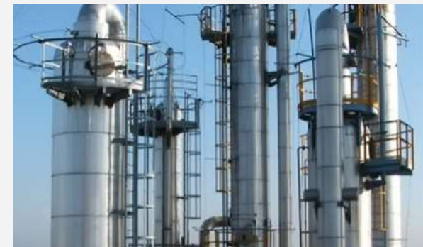
Колонны аминовой очистки для комплекса переработки газа
