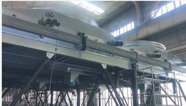
Air coolers for LNG production
